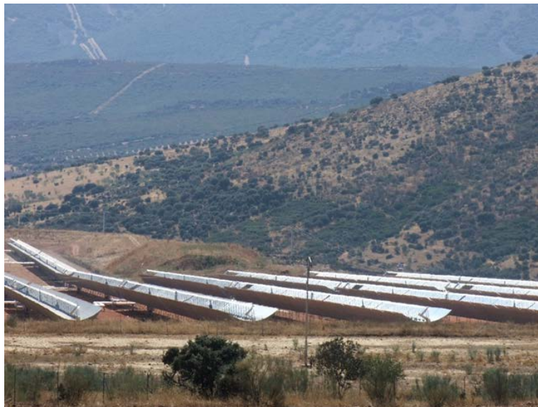
Figura 9. Planta Termoeléctrica IBERSOL PUERTOLLANO
